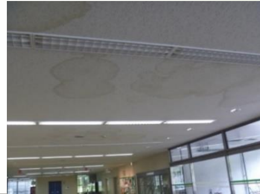
天井：雨漏りや設備からの漏水痕
