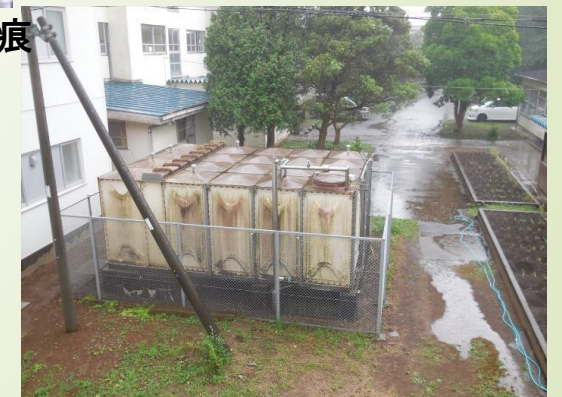
受水槽：錆によるパネルの劣化
