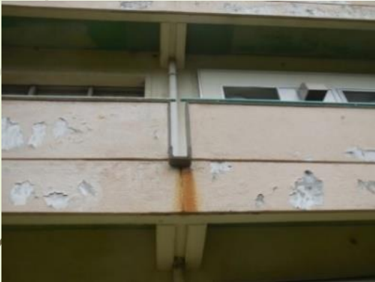
外壁：塗装の剥がれや爆裂
