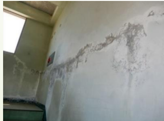
内壁：雨漏りの浸水による塗装劣化
