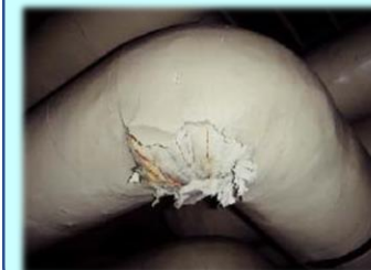
(配管エルボ保温材)
