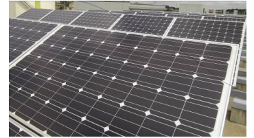
上下水道局睦浄水場の太陽光発電
