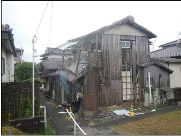
保安上危険となるおそれのある状態
