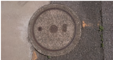
▲写真① コンクリート製の公共ます
