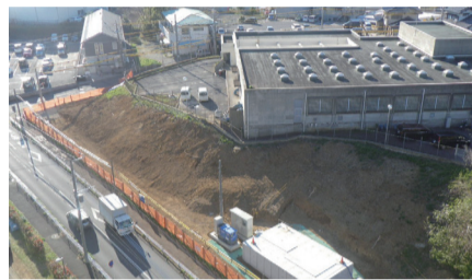
▲村上給水場(令和2年3月撮影)
