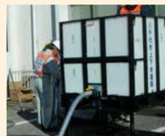
▲組立式の給水タンク
