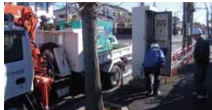
▲停電により稼働停止したマンホールポンプに発電機を接続する復旧作業を確認
