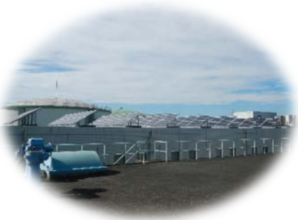
太陽光発電設備
