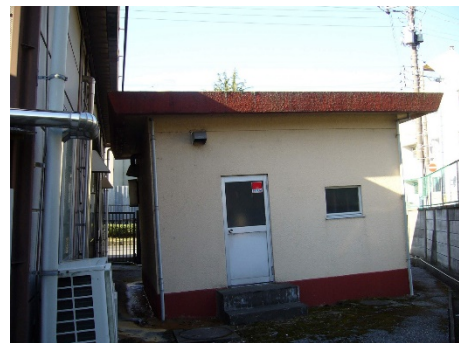
東日本大震災で液状化による建屋傾き
