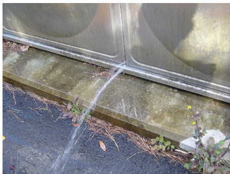
東日本大震災が原因の配水池漏水
