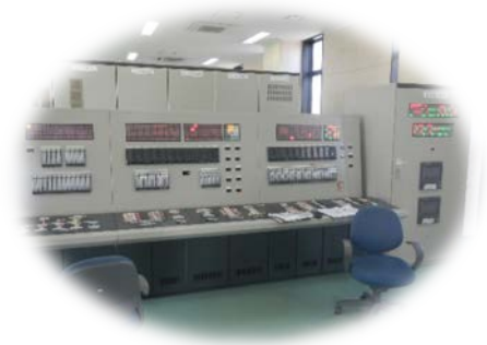
監視制御設備
