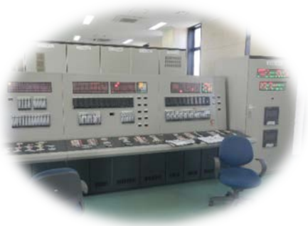
監視制御設備
