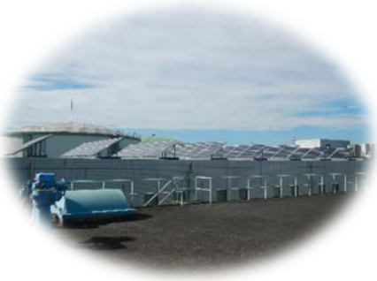
太陽光発電設備
