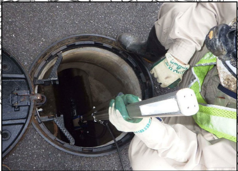
写真: 点検実施状況(管口カメラ点検) ※地上から人孔内部にカメラを挿入し、管内部を撮影して、異常の有無を確認しています。
