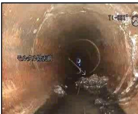
施工前：老朽化が進んだ下水道管（内部）
