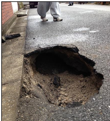
道路陥没事故事例（八千代市）
