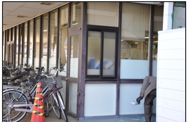
ガラスが割れた庁舎
