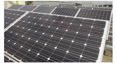
上下水道局睦浄水場の太陽光発電
