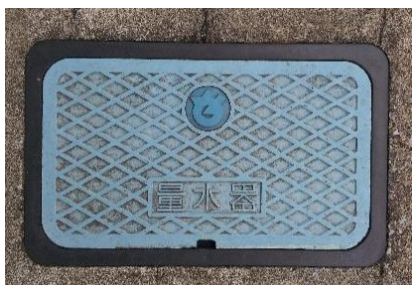
▶ 水道メータボックス
