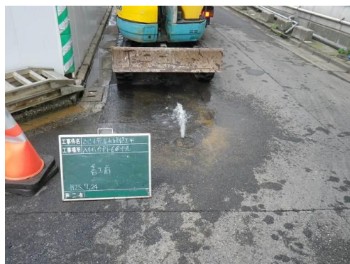
▲道路上で漏水している様子
