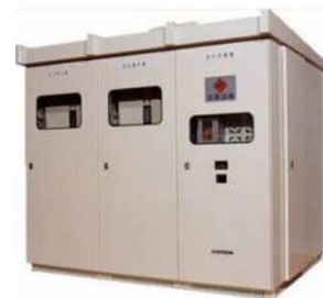
図3-4 屋外キュービクル
