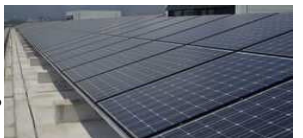
図3-5 太陽光発電パネル
