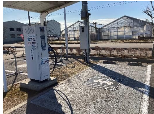
農業交流センターのEV車充電施設
