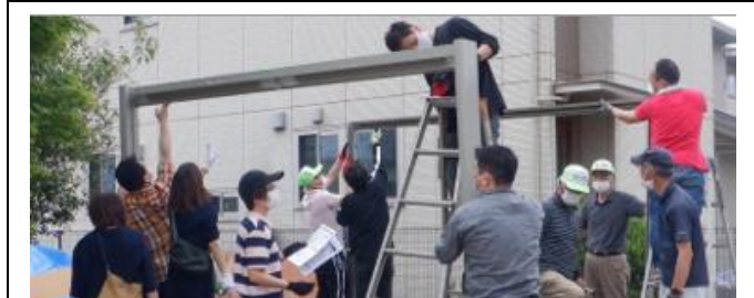
防災倉庫の設置
