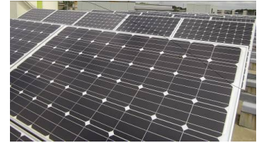
上下水道局睦浄水場の太陽光発電
