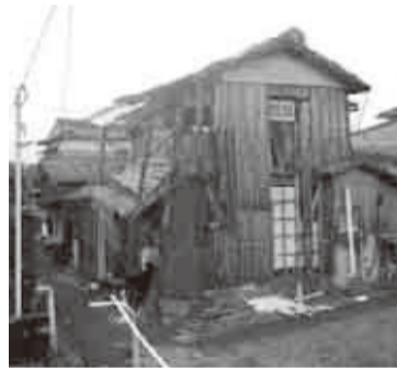
▲建物の外壁が朽ちて、倒壊のおそれがあります
