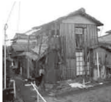
▲建物の外壁が朽ちて、倒壊のおそれがあります
