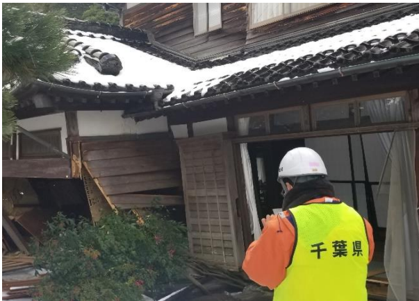
住家被害認定調査
