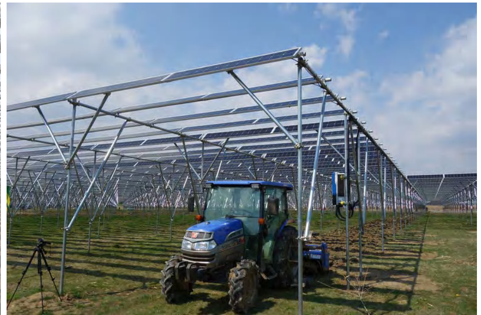
市民エネルギーちば(株) 千葉県匝瑳市 匝瑳メガソーラーシェアリング第1発電所 27
