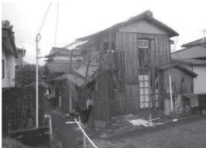
建物の外壁が朽ちて、倒壊のおそれがあります
