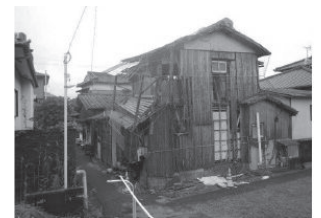
建物の外壁が朽ちて、倒壊のおそれがあります
