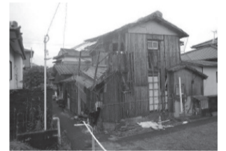
▶防災性の低下に伴い建物の外壁が朽ちて倒壊の恐れがあります
