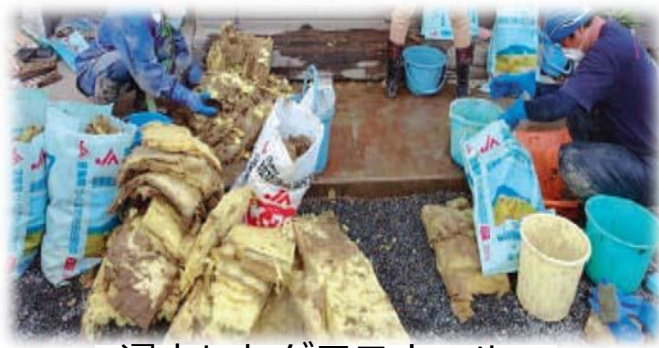
浸水したグラスウール
