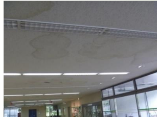
天井：雨漏りや設備からの漏水痕
