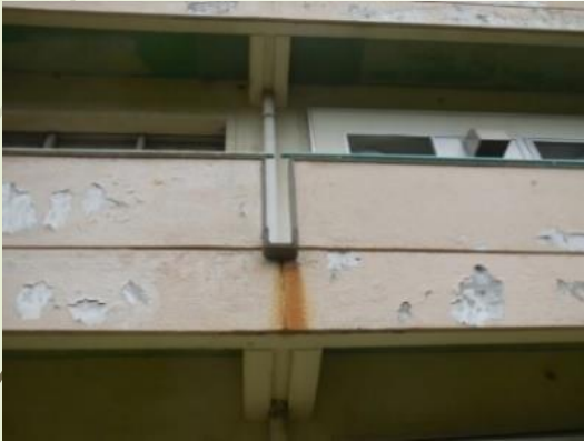
外壁：塗装の剥がれや爆裂
