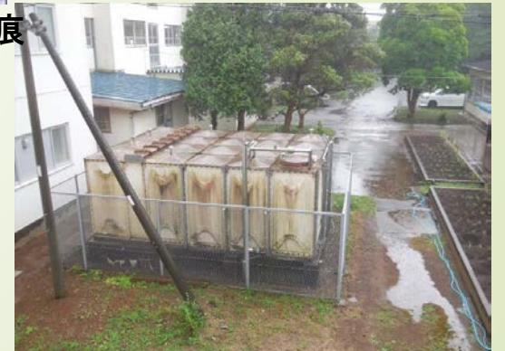
受水槽：錆によるパネルの劣化
