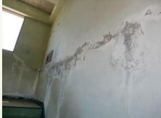
内壁：雨漏りの浸水による塗装劣化
