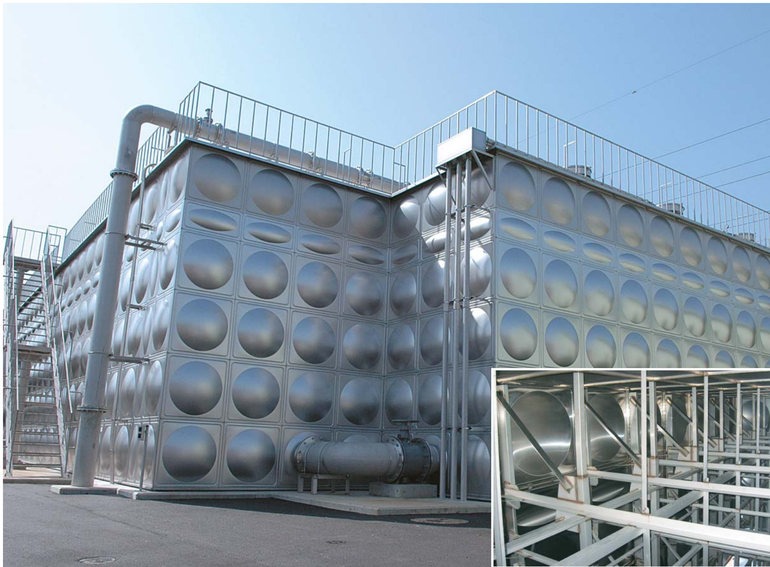
▲勝田台浄水場のステンレス製配水池。ステンレスは、劣化が少なく長持ちします。また、衛生的にも優れた素材です
