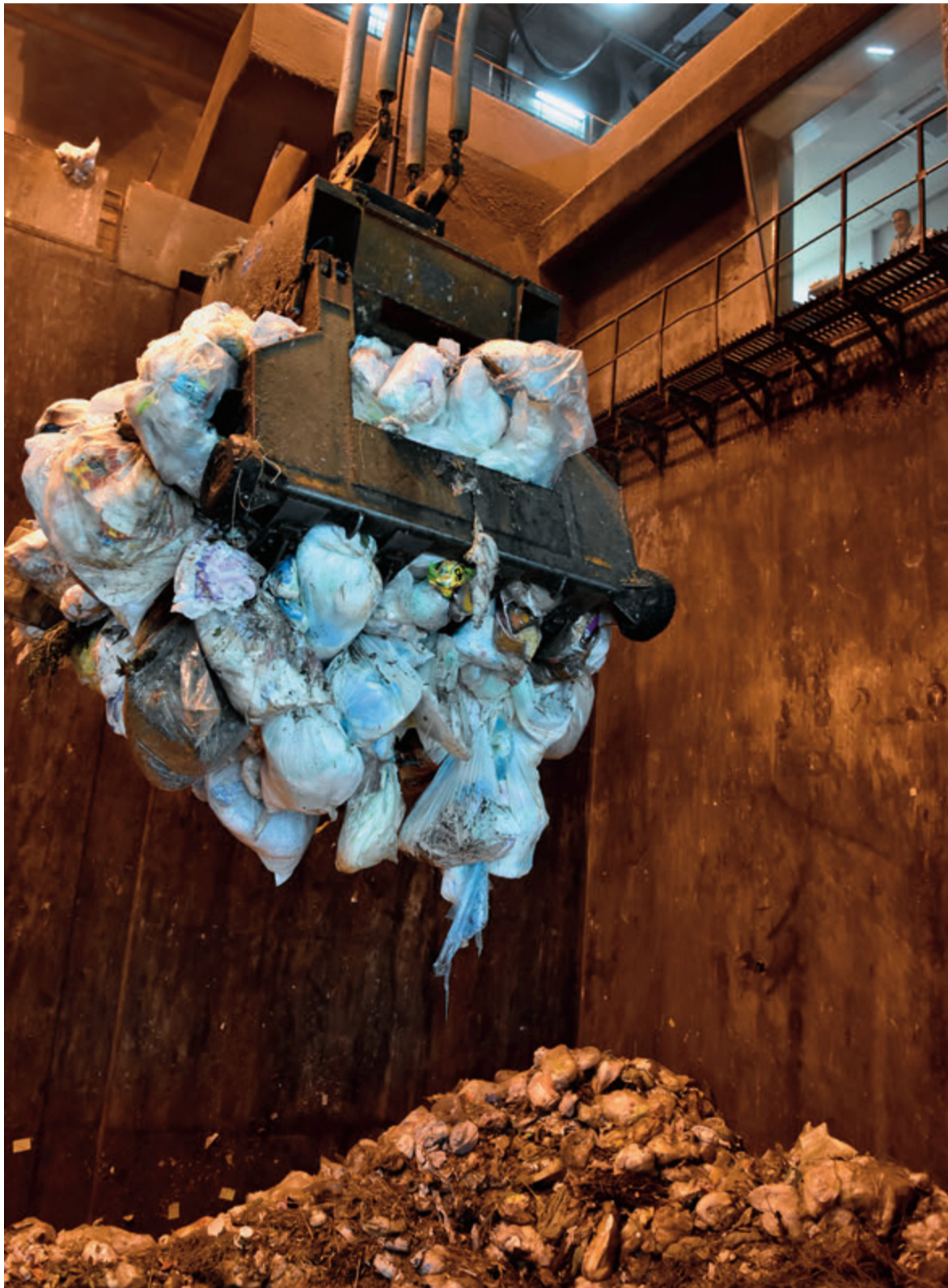
▲クレーンですくい上げ、隣の焼却炉へ。灰の一部は建設資材にするため外部施設で再資源化します。
