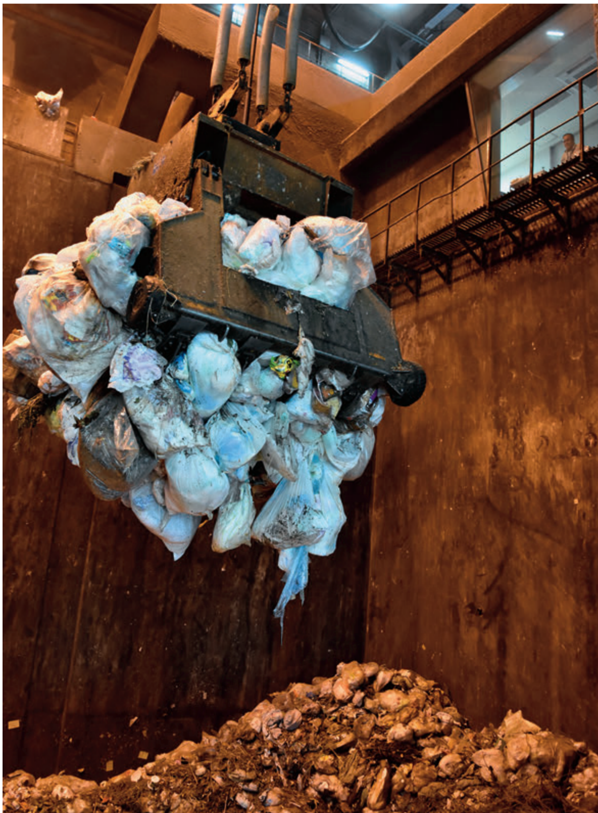
▲クレーンですくい上げ、隣の焼却炉へ。灰の一部は建設資材にするため外部施設で再資源化します。
