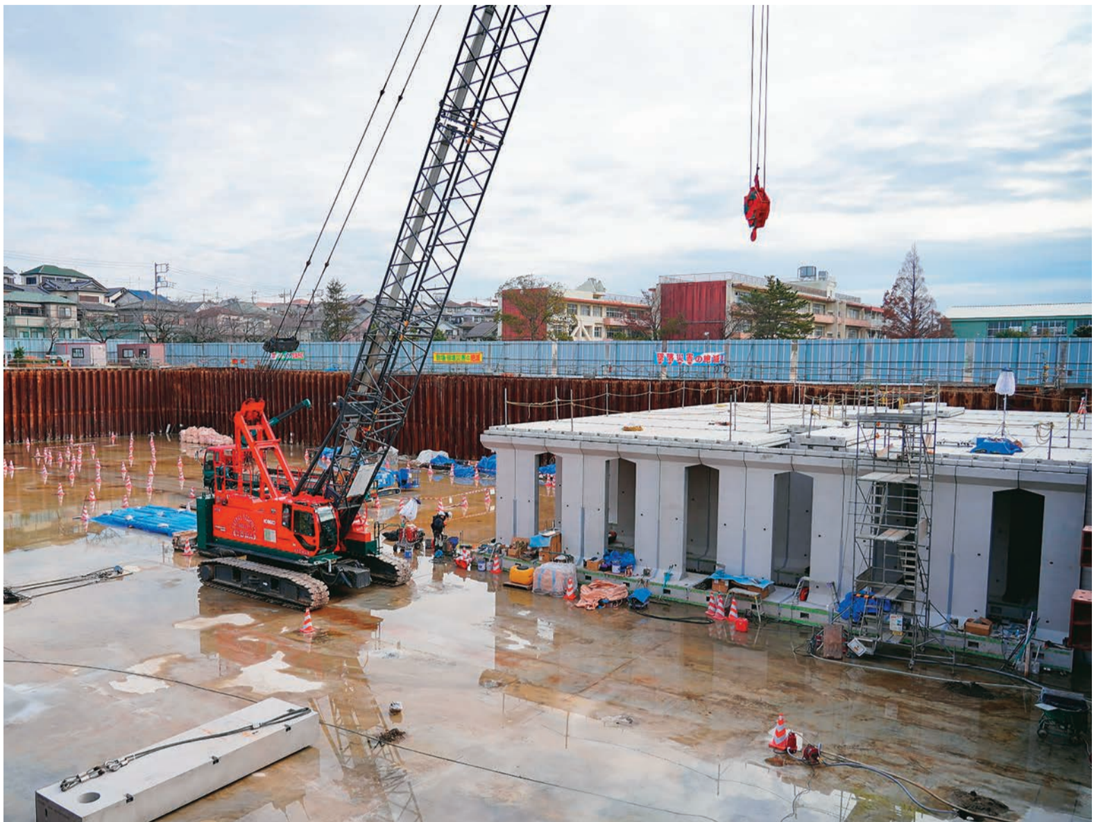
▲降った雨を調整池に一時的に溜めます。溜まった雨水は、八千代1号幹線(旧高津川)から花見川に放流していきます
