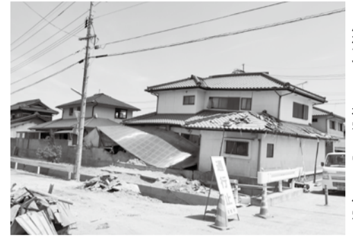
▲倉敷市真備町で豪雨のため屋根瓦などに被害を受けた住宅
