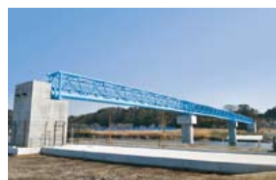
▲1日に平均1万1,000㎡を送水する宮内水管橋
