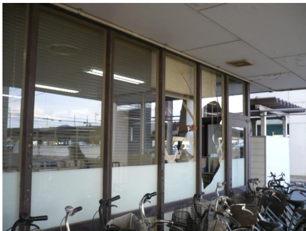
旧館1階の窓の破損
