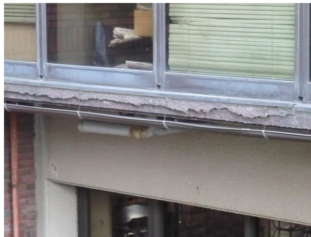
旧館外壁の剥離
