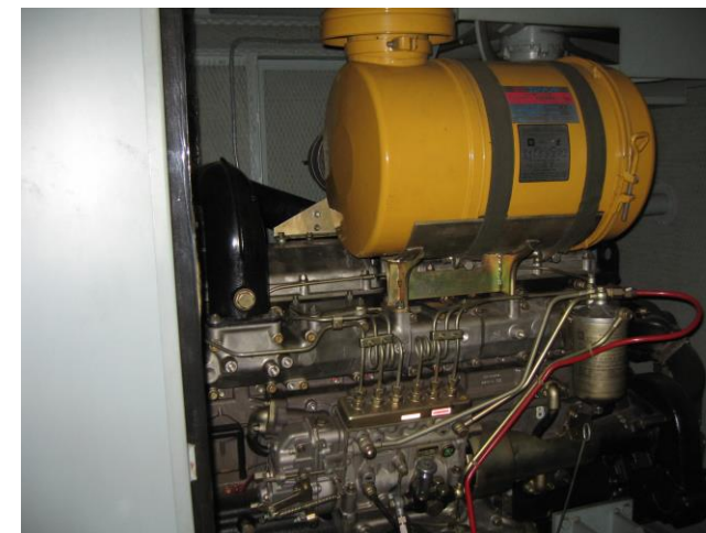
非常用発電機
