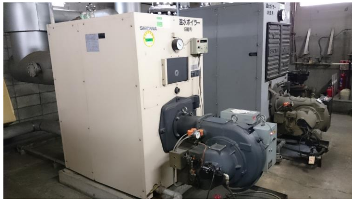
温水ボイラー
