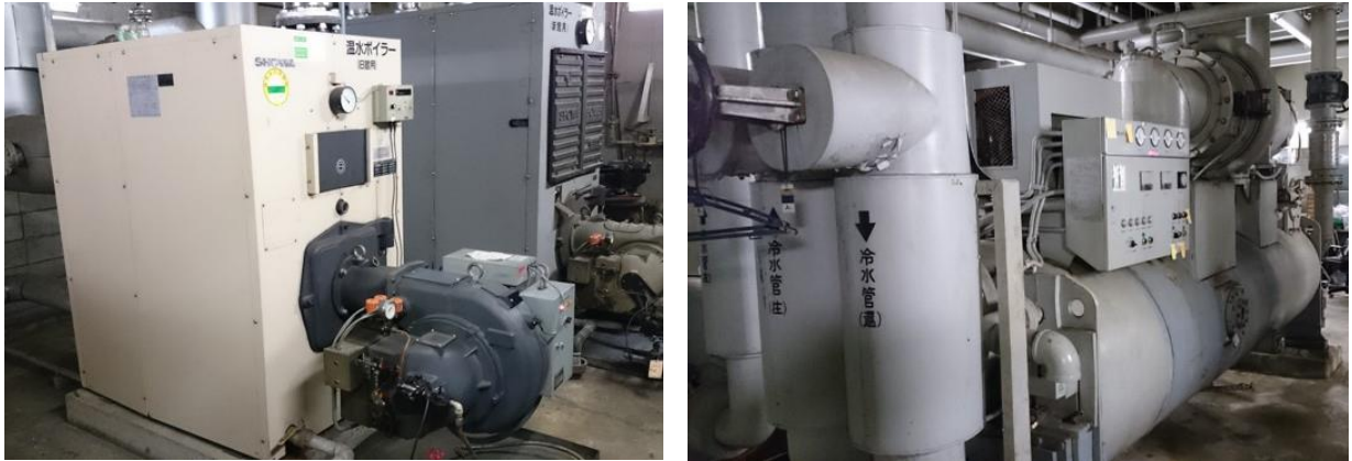
図 2.14 旧館及び新館の設備(左:温水ボイラー 右:冷房用ターボ冷凍機)
