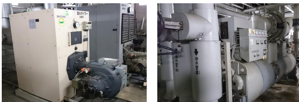
図 x 旧館及び新館の設備(左:温水ボイラー 右:冷房用ターボ冷凍機)
