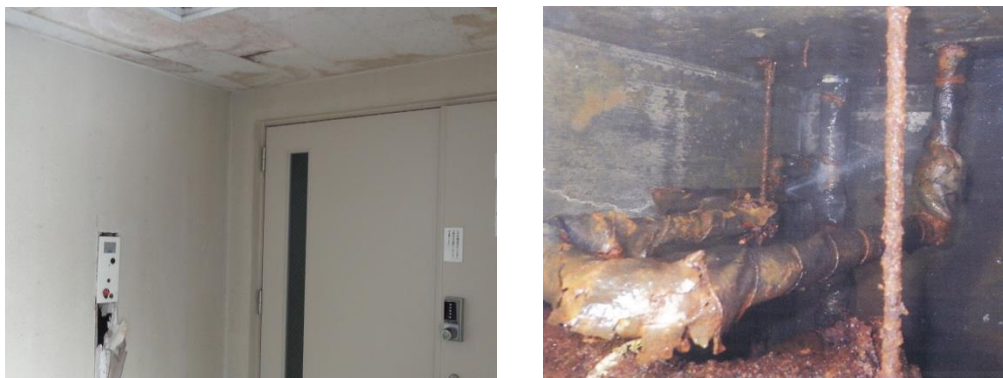
図 2 老朽化の現状(左:雨漏り跡, 右:老朽化した配管)
